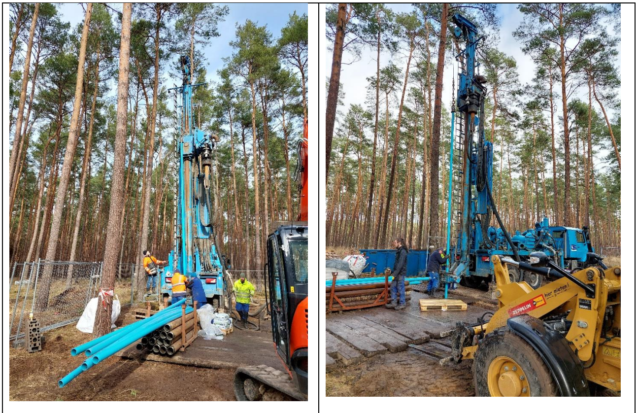
Abbildung 4-2: Messstellenbau an der Hy Fu 1/2022 (links) und an der Hy Fu 3/2022 (rechts)
