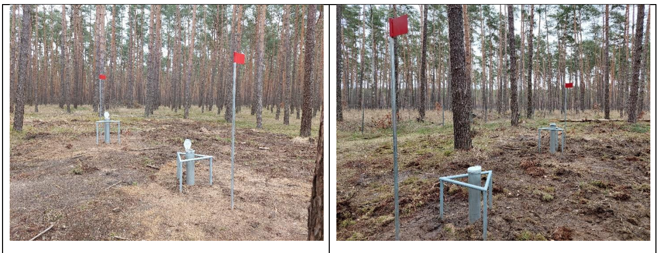
Abbildung 4-3: Fertiggestellte Messstellen Hy Fu 1/2022 OP/UP (links) Hy Fu 3/2022 OP/UP (rechts)
