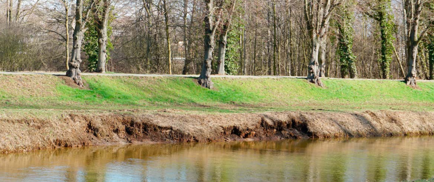
Böschungsschäden an Schwarzer Elster durch eingebrochene Nutriabaue
