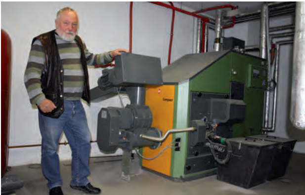
Abb. 5.43: Herbert Habicht beheizt das Betriebsgebäude seines Unternehmens mit Holzschnitzeln aus dem eigenen Biofestbrennstoffhof
