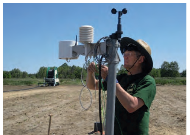
Abb. 5.9: Aufbau der Klimastation
