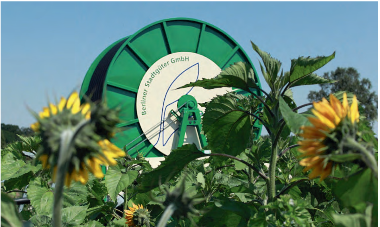
Abb. 5.1: Schlauchtrommelregner im Energiefeld
