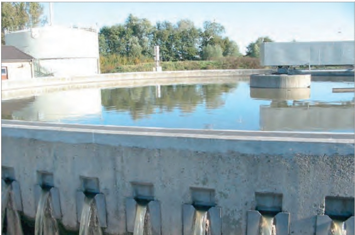
Abb. 5: Überlauf eines Vorklärbeckens auf der Kläranlage Brandenburg-Briest
