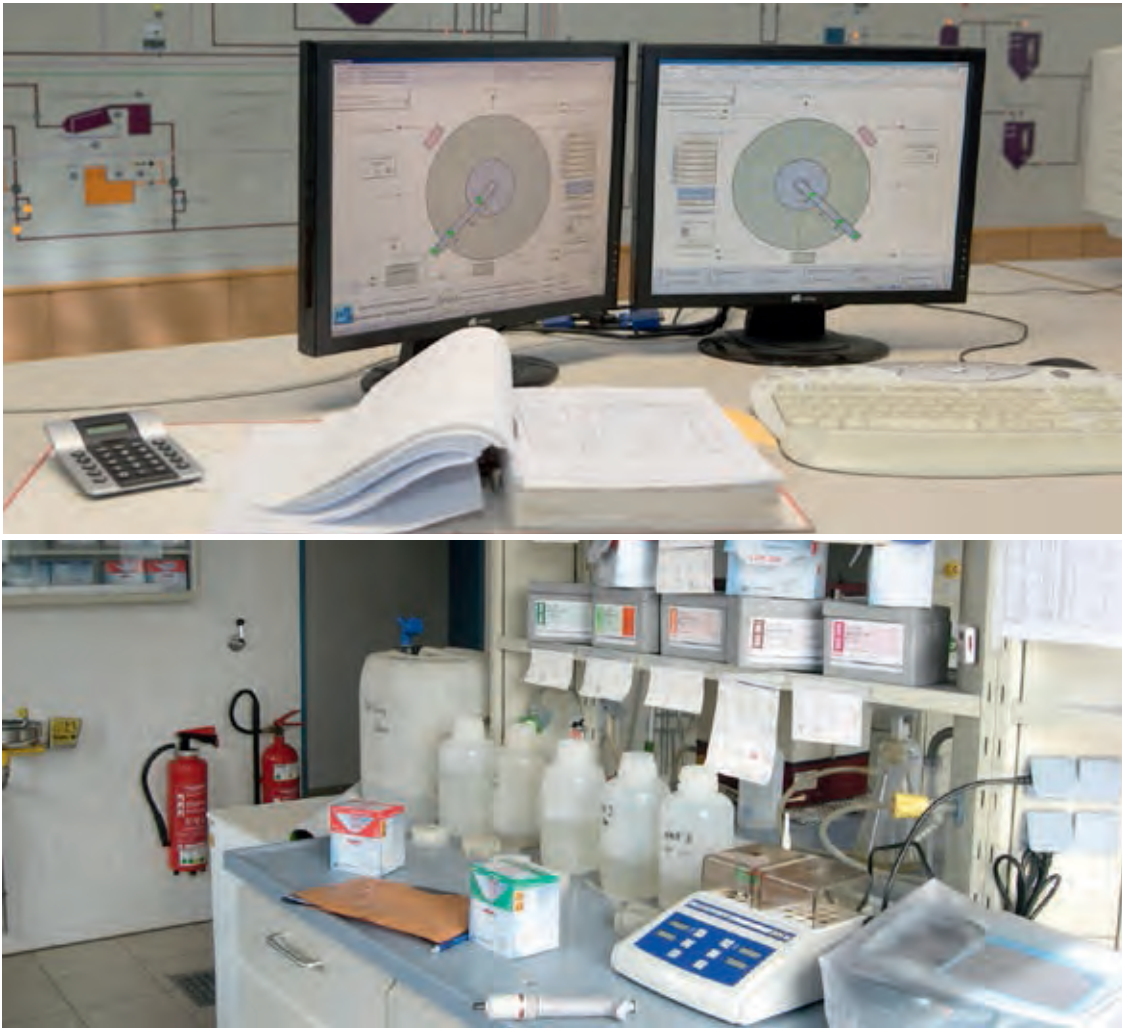
Abb. 11: Labor und Schaltwarte der Kläranlage Elsterwerda
