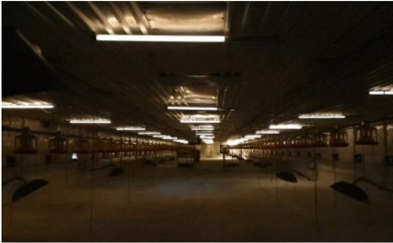
Abbildung 56: Lichtkegel (rechts) durch defekte Leuchtstofflampe während der Dimmphase (© StanGe, Hochschule Osnabrück)
