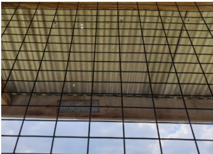
Abbildung 51: Löcher im Dachüberstand als Ursache für Lichtflecken im Stall (© StanGe, Hochschule Osnabrück)
