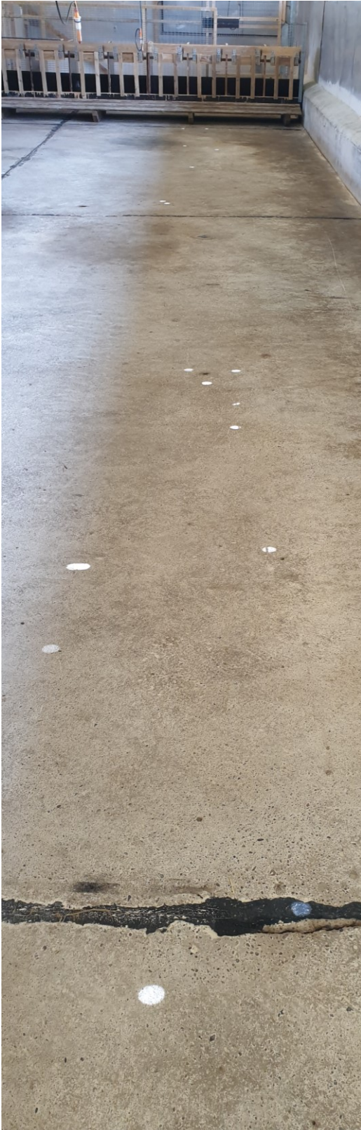
Abbildung 52: Lichtflecken auf dem Stallboden aufgrund von Löchern im Dachüberstand (© StanGe, Hochschule Osnabrück)
