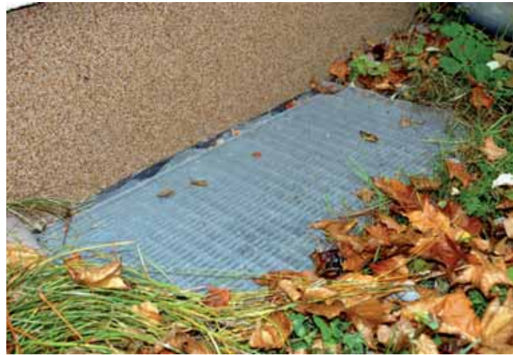
Abb. 103: Mit Gaze abgedeckte Kellerschächte sind sicher für Amphibien. Foto: Norbert Schneeweiß
