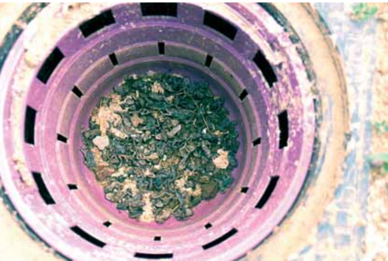
Abb. 77: Straßenentwässerung als Amphibienfalle an der Bundesstraße 2n bei Schwedt. Foto: Norbert Schneeweiß
